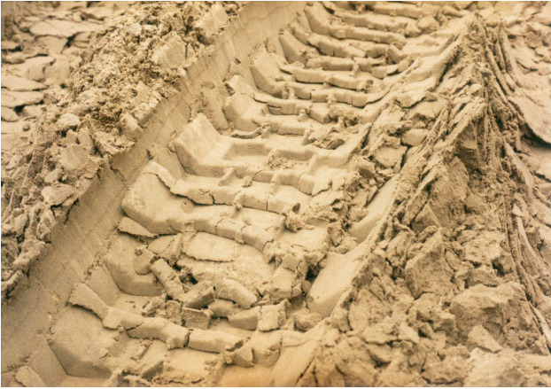
a) Sable légèrement humide et compact. Le fond de l'ornière montre les empreintes des sculptures. Ces empreintes se chevauchent légèrement, laissant apparaître un début de cisaillement longitudinal de la couche de roulement.
